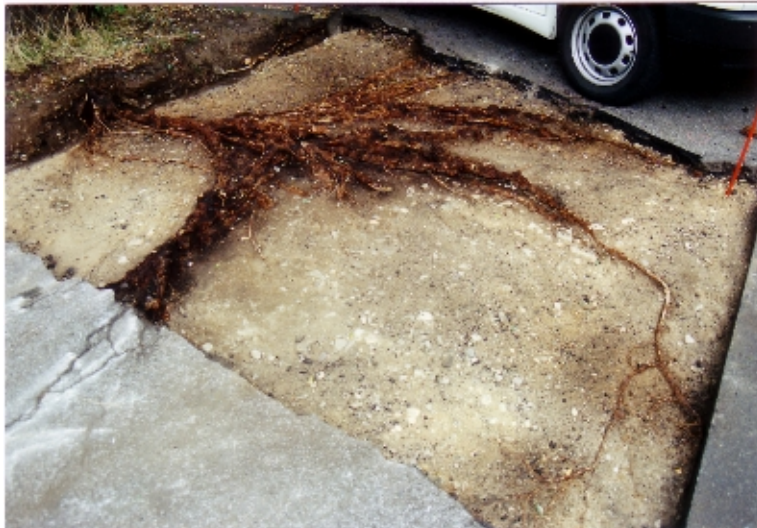
Abb. 6: Wurzelwachstum, wo man es eigentlich nicht vermutet: Wurzelpartie von Robinia pseudoacacia in der Grenzzone zwischen Tragschicht und Asphaltdeckschicht.
