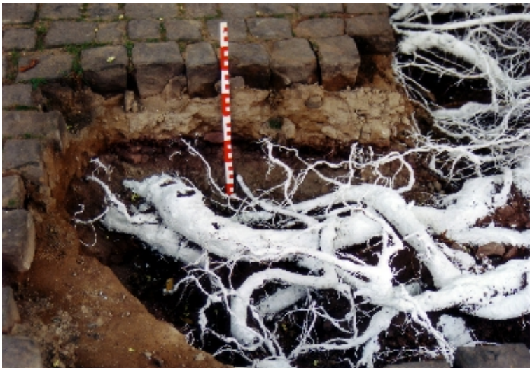
Abb. 7: Starkwurzeln von Sophora japonica in der Tragschicht. Der Schaden ist in dieser Tiefe trotz großer Wurzeldicken gering.
