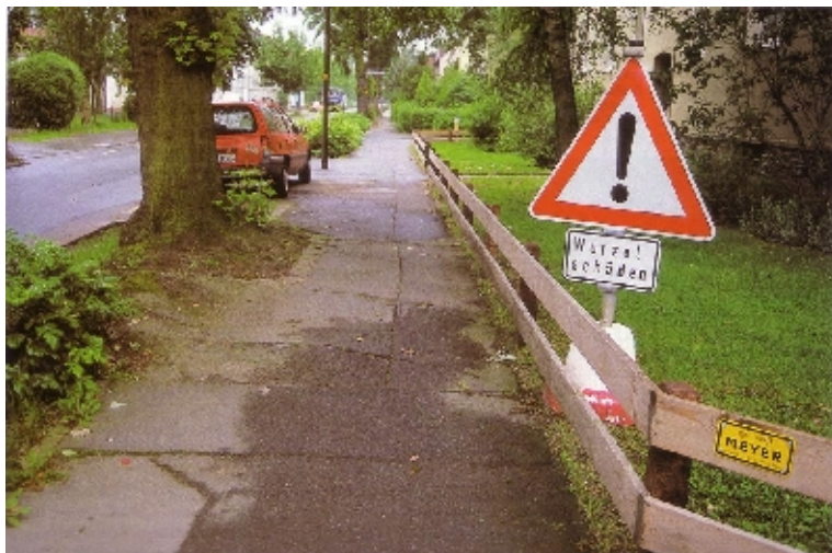
Abb. 1: Eine Frage der Verkehrssicherheit: Anhebungen im Gehwegbereich durch Baumwurzeln.
