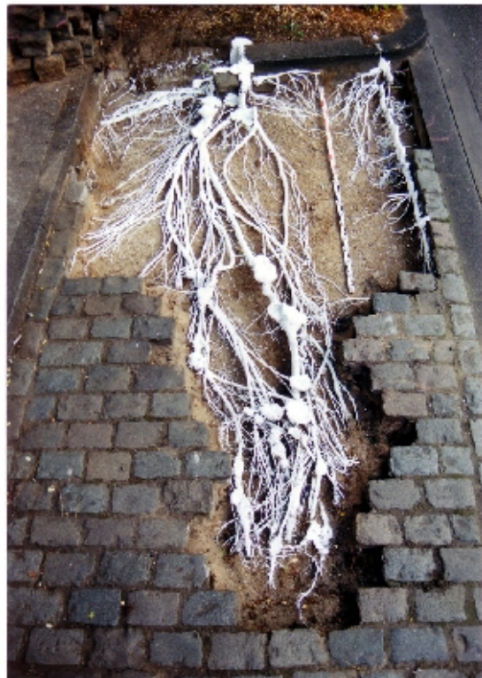
Abb. 4: Robinia pseudoacacia – Durch eine Fuge im Bordstein gelangen die Wurzeln in die Plasterbettung des Parkstreifens. An den Auflagepunkten des Pflasters haben sich starke Verdickungen gebildet.
