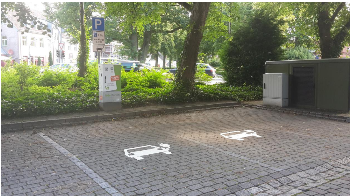
Abbildung 3: Von der VS installierte öffentliche Ladesäule in Bargteheide (Abbildung: Vereinigte Stadtwerke GmbH).
